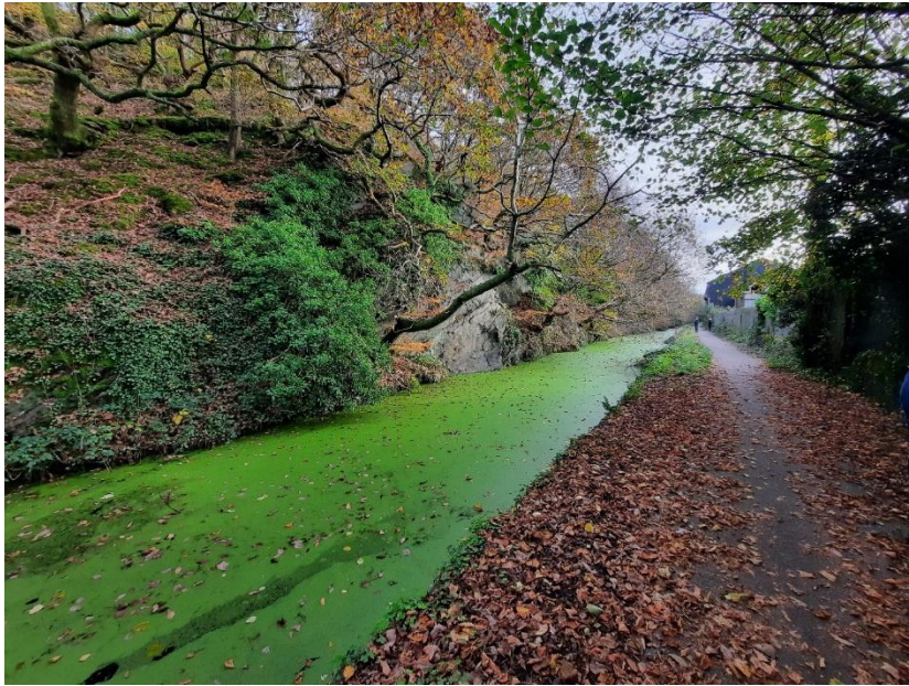
Ffigur 7-11 - Yr adran o'r sianel rhwng y Bont Ddiemwnt ac Afon Nedd
