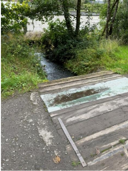
Delwedd 45 – Gorlifan i Afon Nedd ger Pont Gerddwyr Howard
